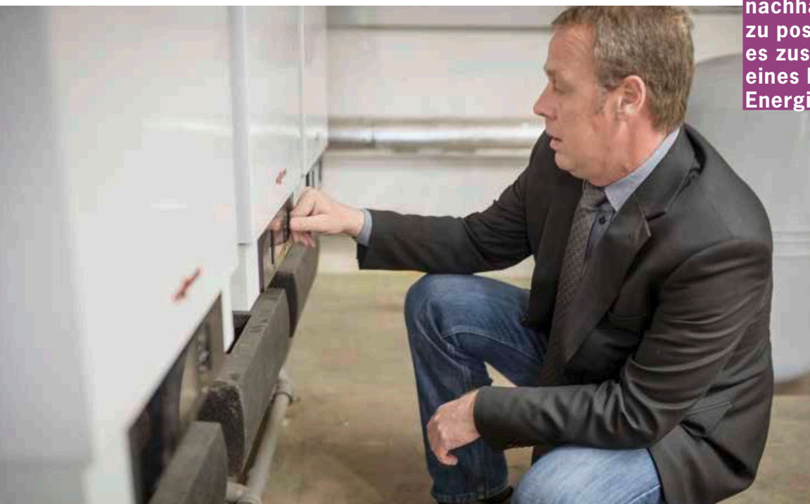
Ralf Melzer, Leiter technisches Controlling und Wärmeservice, beim Prüfen einer Heizanlage im Wärme-Contracting
